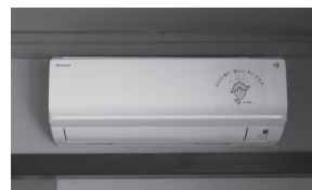
整備されたエアコン2台
