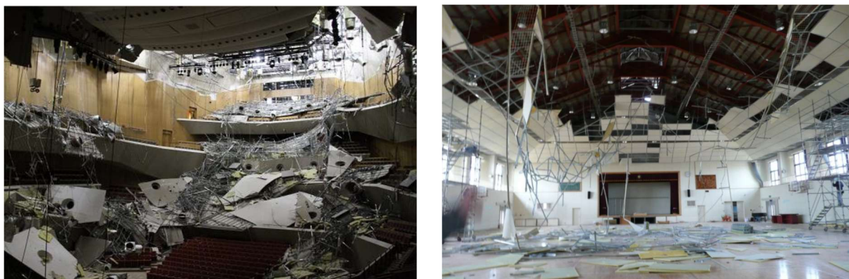
図 3-4 天井材の落下による被害の状況
