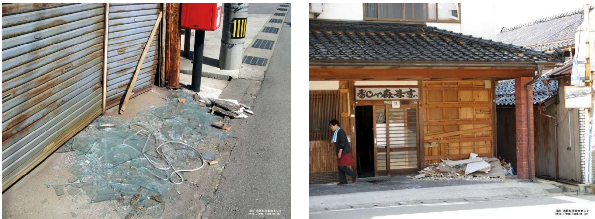
図 3-3 落下物による被害の状況
