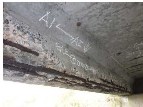
コンクリート橋の剥離・鉄筋露出等
