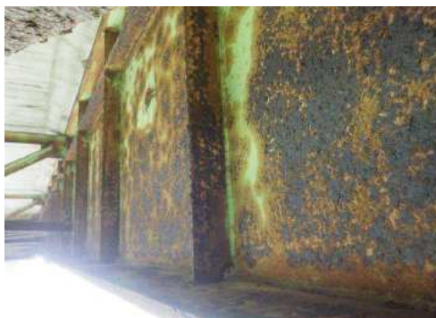
鋼桁の腐食等
