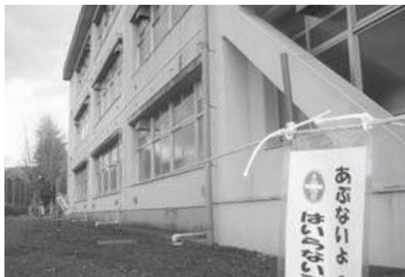
老朽化した中条小学校校舎
