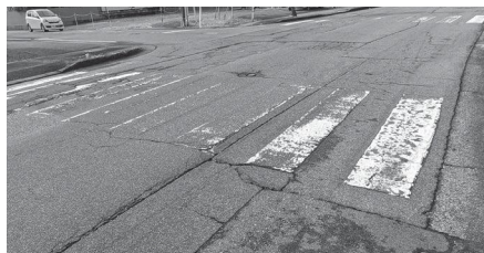
消えかかっている路面標識
