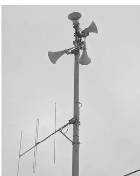
防災行政無線 屋外スピーカー
