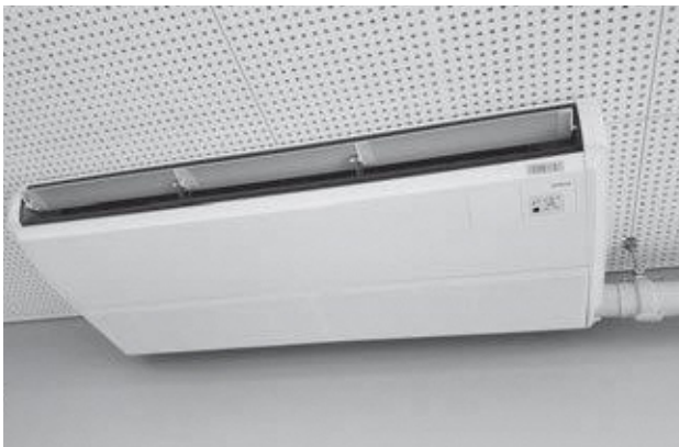
特別教室に設置が望まれるエアコン
