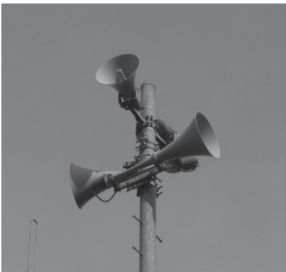
防災行政無線屋外スピーカー
