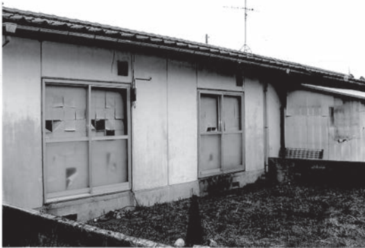
老朽化した空き家状態の黒川住宅
