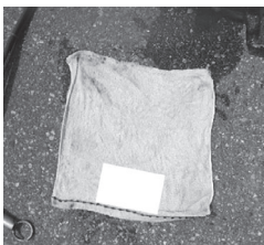
ポンプ場に絡まり故障の原因となったタオル
