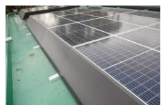
太陽光発電設備
